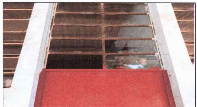
Foto 4: se sustituirán las ventanas dañadas
