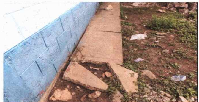
Foto 6: las banquetas se han quebrado y deteriorado
